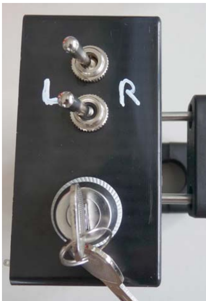
Batería izquierda conectada
